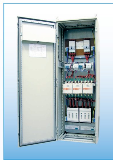
Шкаф автоматического ввода резерва
